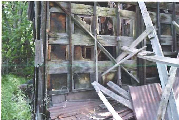
Site 3: Mill: Collapsed Wall
